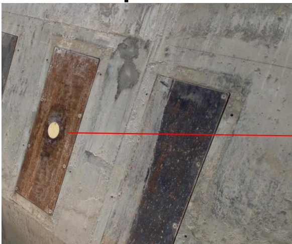
Sensor Einbau in Materialrutsche
