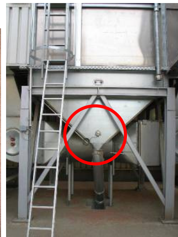
Getreide/Mais in Trocknungsanlagen
