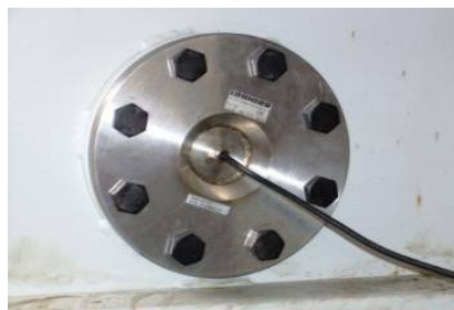
Sensor eingebaut in Tank
